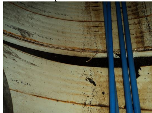
Figura 5: Abertura na parte inferior do tubo.
