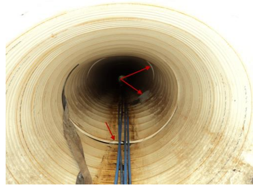
Figura 4: Fissuras na parte inferior e na parte superior do tubo.
