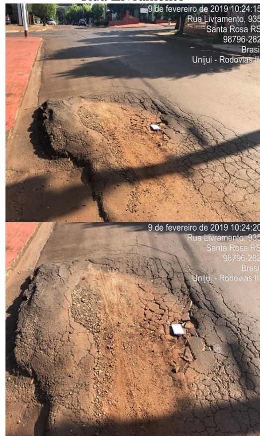
Figura 6. Afundamento Local Plástico na Rua Livramento
