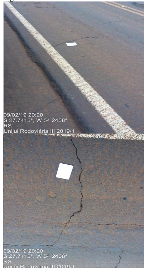
Figura 4. Trinca transversal na RS-342
